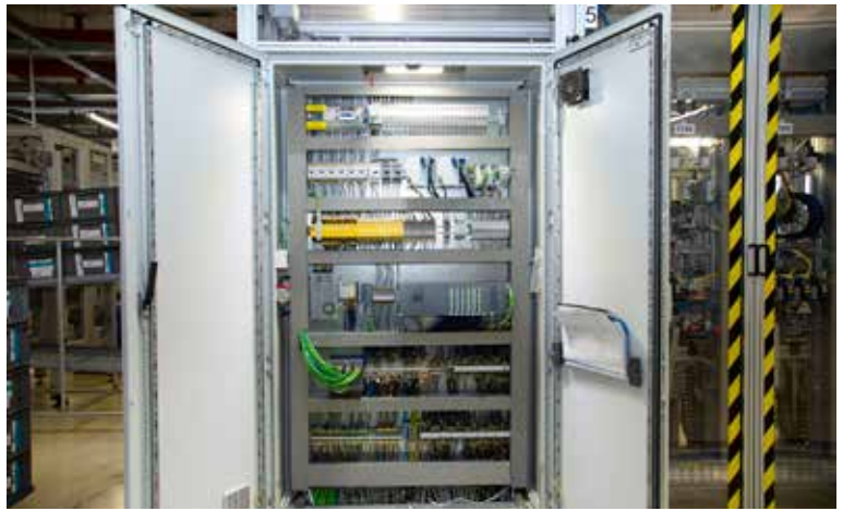
Die Industrial Security Appliance Scalance S615 im Schaltschrank erhöht die Cybersecurity an jeder Produktionslinie.
