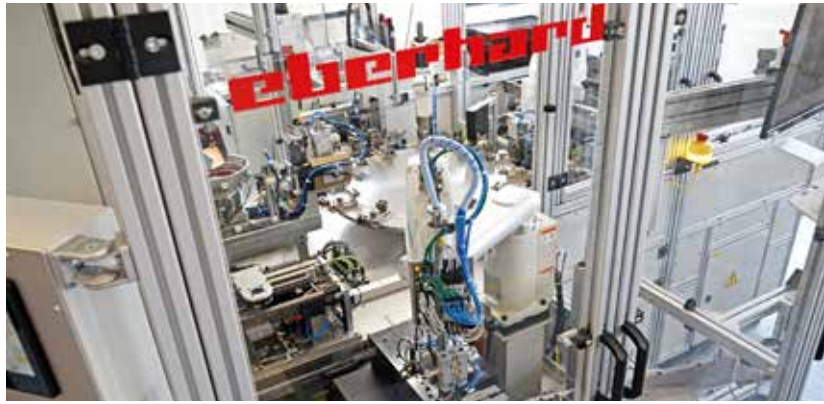
Bei der Konzeption und Realisierung der Anlage konnte Eberhard aus dem vollen Turck-Programm schöpfen, von Sensorik über I/O-Module bis zu HMI und Cloud.
