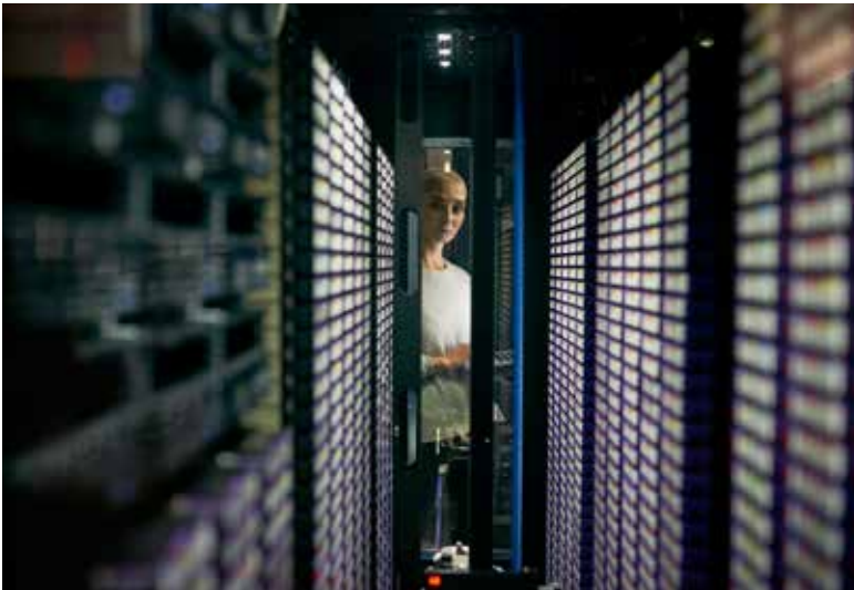
Der Serverraum stellt alle wichtigen Unternehmens-Applikationen zur Verfügung. Dieser bildet die Schaltzentrale für das Zero-Trust-Konzept.
