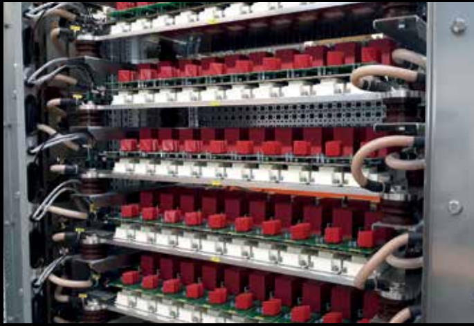
Der 35kA IGBT-Schalter besteht aus sechs einzelnen Einschüben die sich den Strom intern aufteilen.
