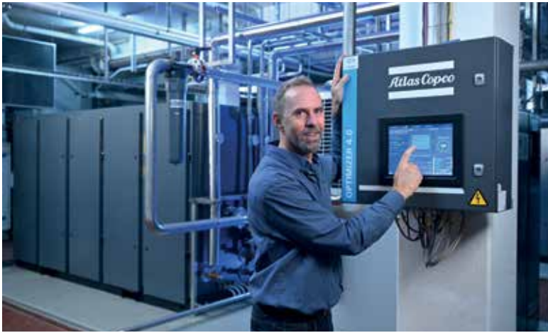
Wolfgang Menger, Energiemanager bei Copenrath & Wiese in Mettingen, zeigt an der übergeordneten Kompressoren-Steuerung Optimizier 4.0, in welchem Druckband die Druckluft erzeugt wird.
