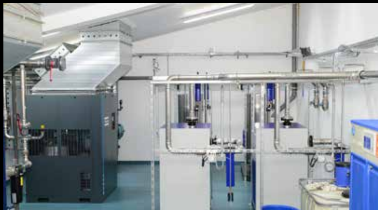
Die Druckluftaufbereitung bei Tetra: vorne die beiden Kältetrockner Drypoint RA, dahinter die Konvertersysteme Bekokat, links der Kompressor.
