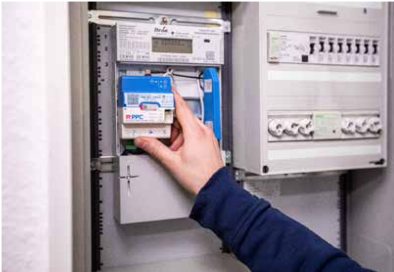
Das Smart Meter Gateway (SMGW) in einem Verteilerschrank sorgt für eine intelligente Kommunikation zu allen relevanten Energiesystemen.
