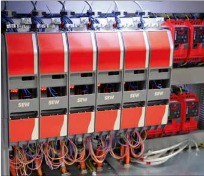
Die sechs Movidrive modular Antriebsumrichter treiben je eine Doppelachse an und verfügen über integrierte Safety-Funktionen.
