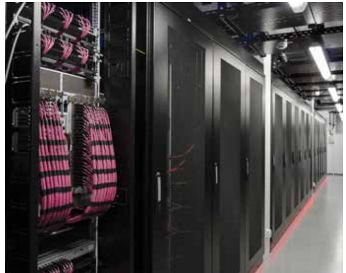
Für das steigende Datenaufkommen ist der Einsatz von Glasfaser-Datenkabeln im Datacenter zwingend.
