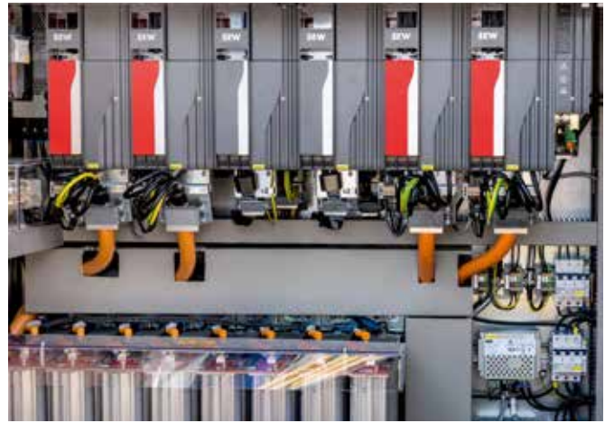
Zwei Versorgungsmodule MDP92A (Mitte oben) sind über den DC-Zwischenkreis mit vier Einachsmodulen MDA90A verbunden.
