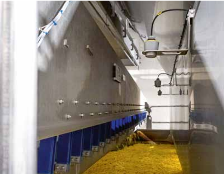
Der VEGAPOINT 11 überwacht die Zuleitung zu den 'Better Tanks'.
