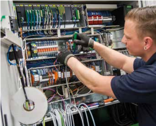
Servicetechniker können durch die digitale Überwachung frühzeitig Probleme beheben.
