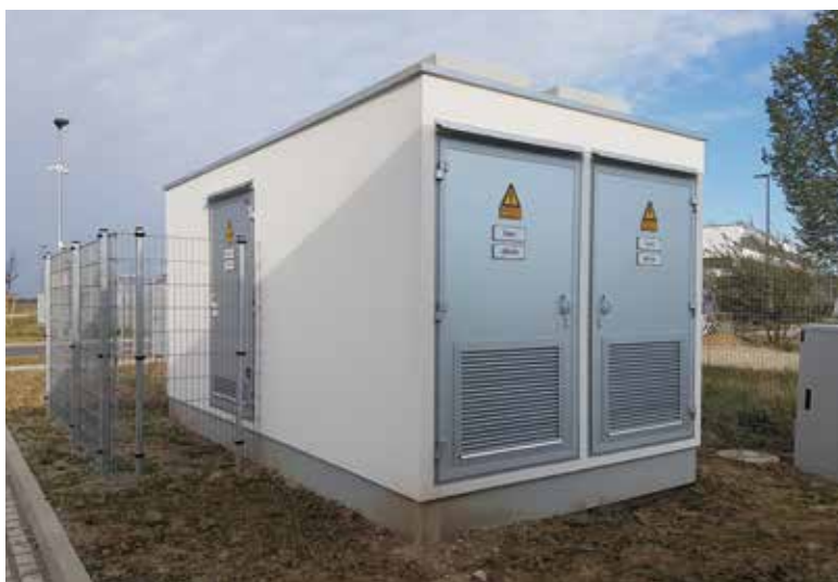
Fertige Kundenstromversorgungsanlage von Baumeister Bahnstromanlagen-Energietechnik.
