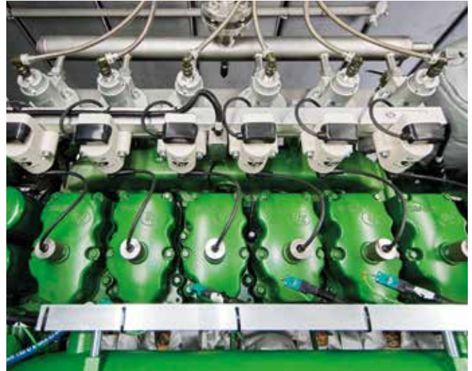
Sensorik überwacht die Hauptkomponenten der Anlage. Die Daten liefern die Grundlage für erforderliche Wartungsarbeiten.
