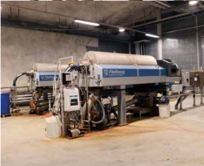
Zwei Flottweg Zentrifugen der C Baureihe behandeln das Abwasser der Stadt Turku.
