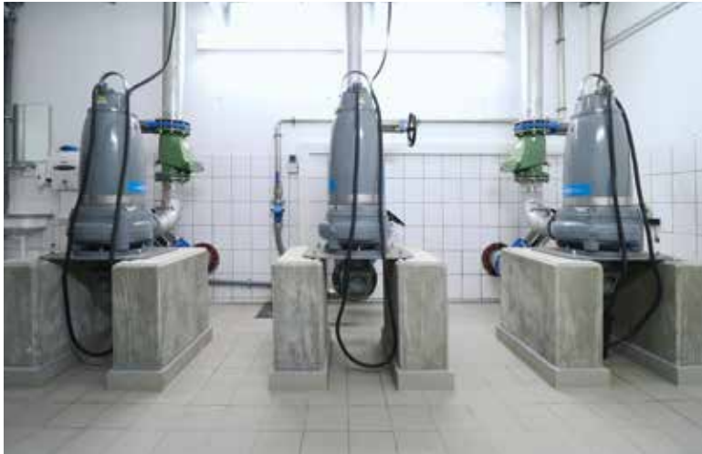
In den großen Pumpwerken sind bis zu drei Pumpen installiert.
