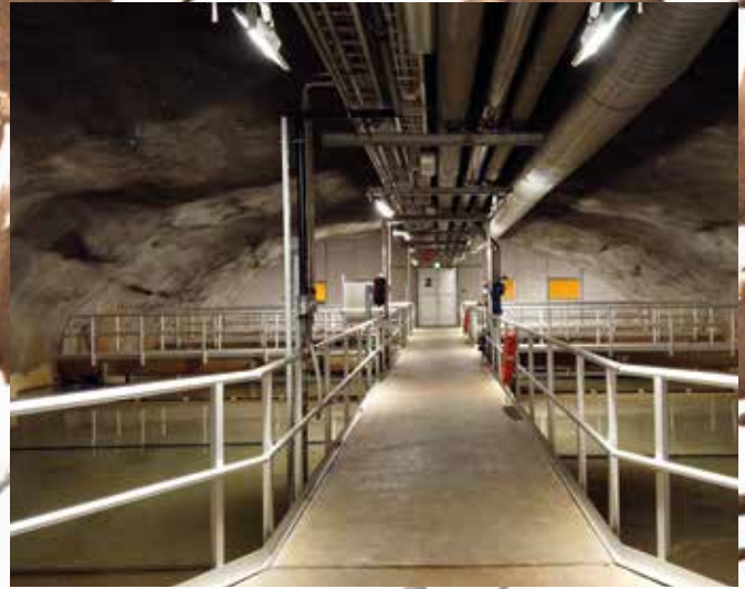
Ein Blick in die unterirdische Kläranlage in Turku Finnland.
