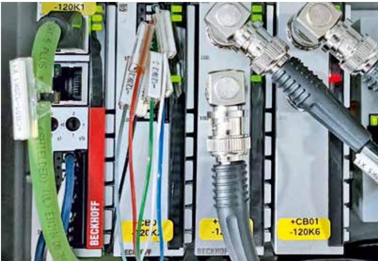
Die hochfrequente Signalerfassung der IEPE-Sensoren erfolgt über zwei- bzw. vierkanalige ELM-Klemmen (ELM360x) mit galvanisch getrenntem EtherCAT-Koppler (EKM1101) und TwinCAT 3 auf einem Schaltschrank-Industrie-PC C6930 im zentralen Steuerschrank.
