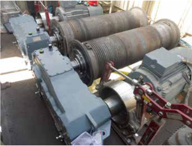
Die beiden neuen Hubwerksgetriebe vom Typ X4FCC140/HC haben jeweils ein dauerfestes Nenndrehmoment von 22.000 Nm.
