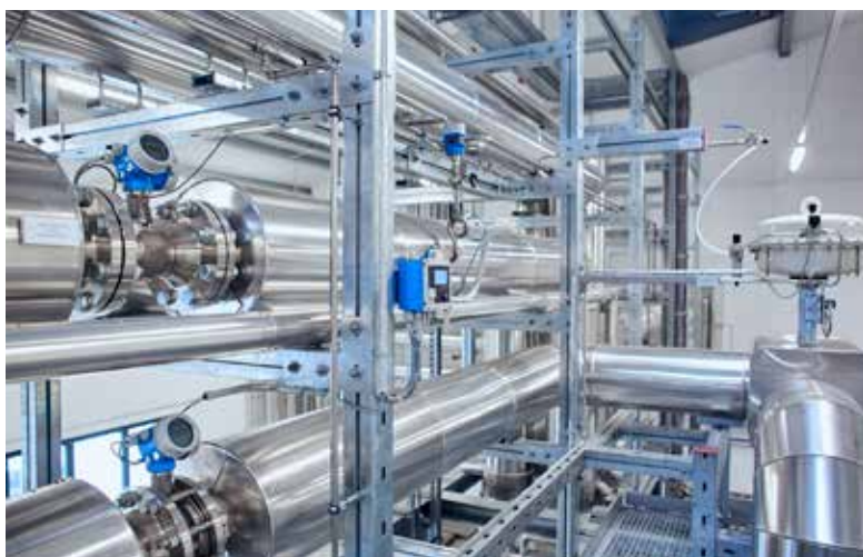
Ein engmaschiges Netz an Messinstrumenten und Energierechnern erfasst die Wärmemengen, die durch Dampfleitungen fließen.
