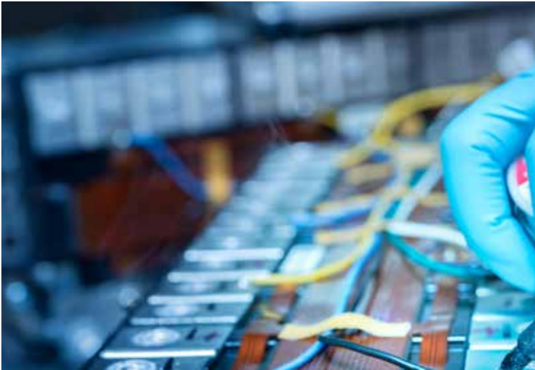
Batterien sind Energielieferanten für die nachgeschaltete Leistungselektronik wie Wechselrichter oder Converter.
