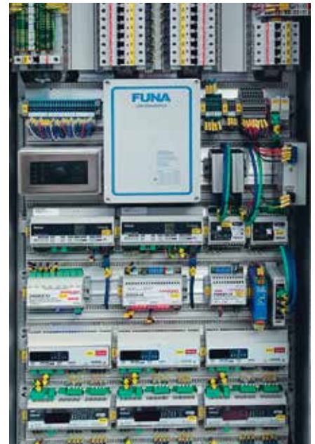
Blick in einen der zahlreichen Steuer-schranke mit dem Lütze-Verdrahtungssystem, das eine kompakte Bauweise erlaubt.
