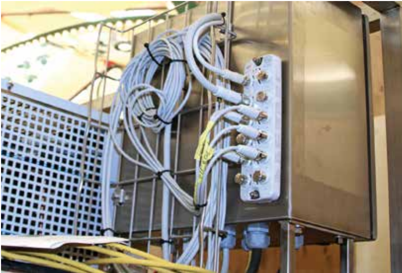
Dezentrale IO-Link-Master sammeln die verschiedenartigen Sensorsignale und leiten sie gebündelt per Profinet an die zentrale Steuerung.
