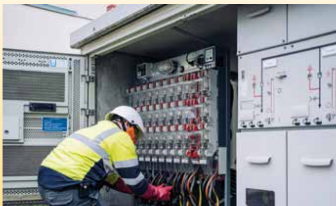
Schnell und einfach sind die ausgewählten Stationen mit SMIGHT Grid2 ausgestattet.
