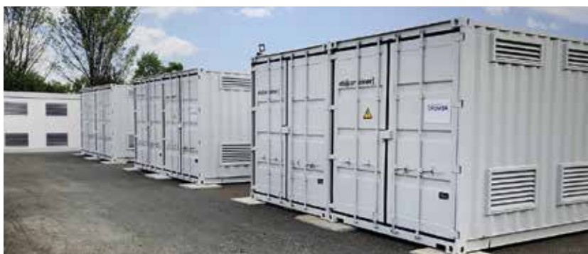
Schlüsselfertig erstelltes Großspeichersystem von Smart Power
