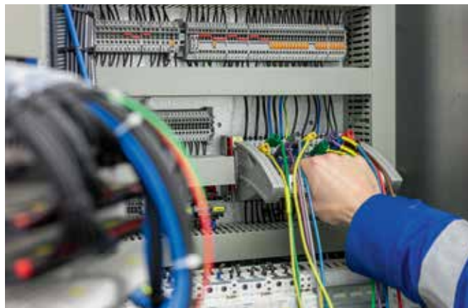
Sicheres, schnelles und komfortables Prüfen: Rheinenergie nutzt das Prüfstecksystem Fame zur Modernisierung ihrer Netze.
