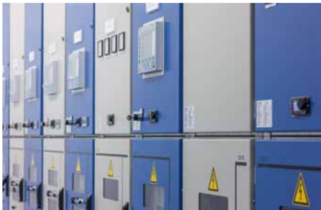
Kleiner und moderner: Die neue Mittelspannungs-Schaltanlage der Rheinenergie im Umspannwerk Worringen umfasst 22 luftisolierte Felder in einer Kompaktstation.
