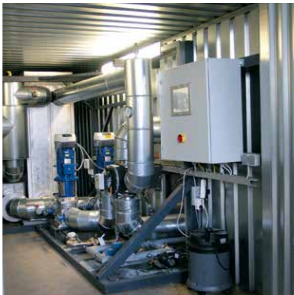
Technikcontainer neben dem Wärmespeicher: Wärmetauscher und Steuerung sind unfern des Wärmespeichers platziert.
